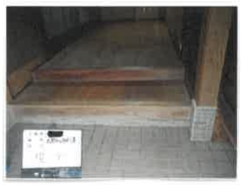
部分的に床が 汚れていました。
